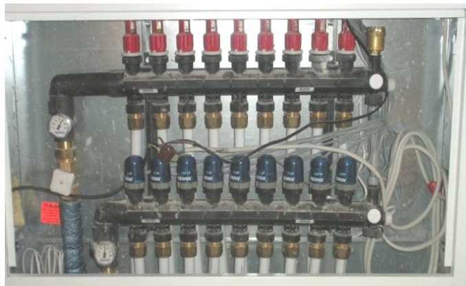
Slika. Razvodni ormar grijanja
